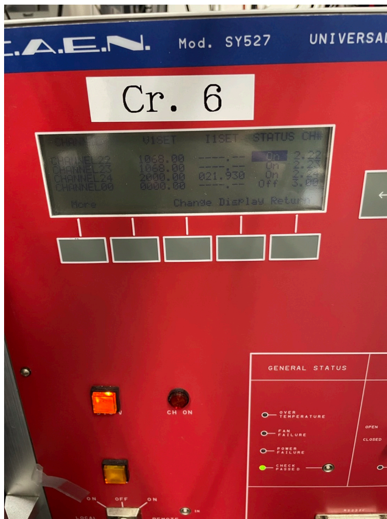
図 2.5: 正極の高電圧電源 (C.A.E.N 社製 SY527)
